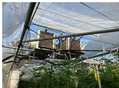
冷・温風扇は単管で頭上設置
